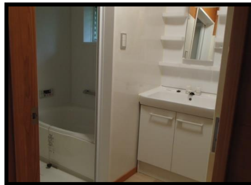
浴室・洗面所
